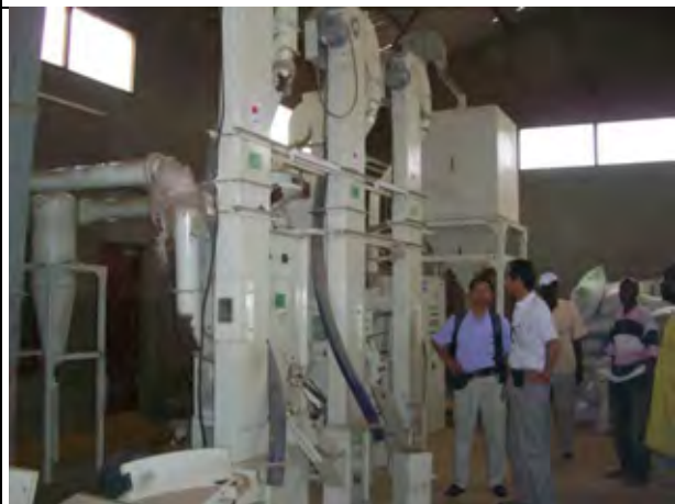
デビ・チゲ灌漑地区における日本の協力により 整備された精米システム
