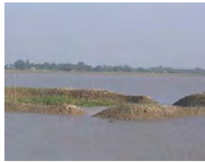
(6) 潜水堤防の損傷状況 (パブリックカット) (乾季 1 月撮影)
