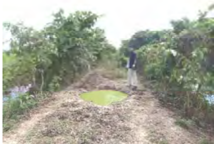
(5) 潜水堤防の損傷状況 (乾季 1 月撮影)
