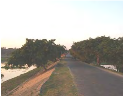
(1) ハオール輪中堤防の損傷 (乾季 1 月撮影)
