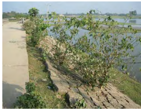
(2) ハオール輪中堤防の損傷 (乾季 1 月撮影)
