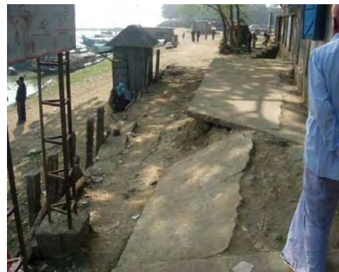
(4) 河川堤防の損傷状況 (乾季 1 月撮影)
