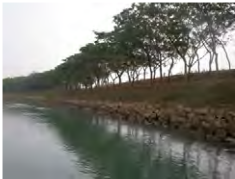
(3) カンクシャ川の河川堤防 (堤内地を防御するため、強固な堤防、護岸となっている) (乾季1月撮影)
