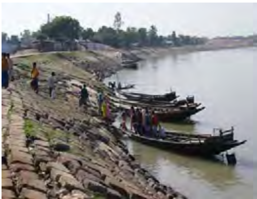
(3) 河川堤防の損傷状況 (乾季 1 月撮影)
