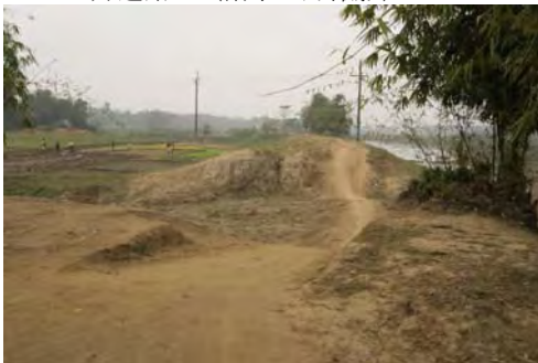
(5) 輪中堤の破堤箇所、3 月いっぱいまでに復旧が必要（乾季 1 月撮影）
