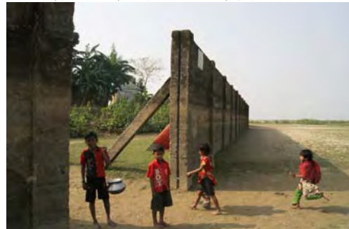
(4) 雨季の波浪から集落を守る防潮壁 (乾季 1 月撮影)
