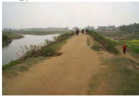
(8) 輪中堤の、降雨による破損箇所（乾季 1 月撮影）
