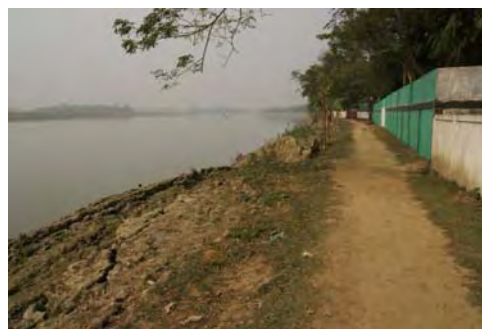
(8) シェルプール地点の河岸侵食、河岸が家屋に接近 (乾季)
