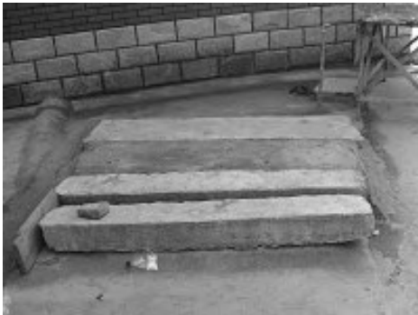
三格式化粪池
