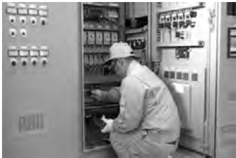
点検作業・絶縁抵抗値の測定 39
