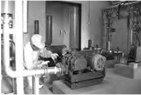
点検作業・ブロワの圧力確認 37
