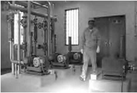
異常の有無確認・ブロワ室にて 31
