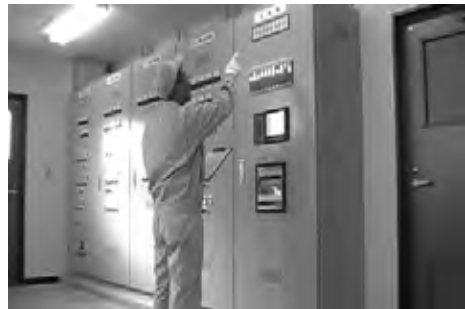
異常の有無確認・制御盤にて
