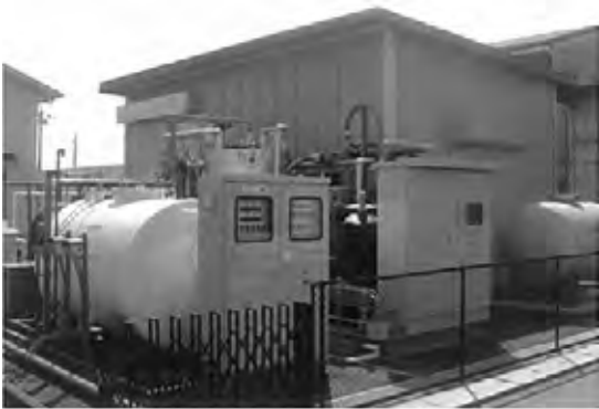
写真 2-1 メタン発酵実証施設
