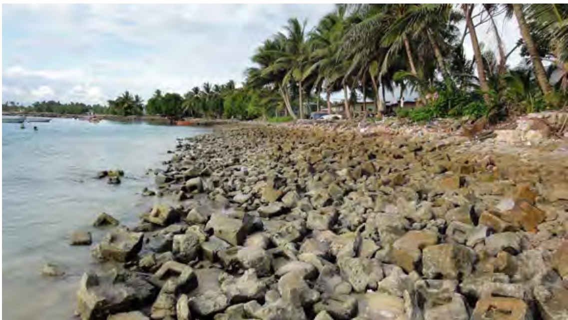
写真 11.1 崩壊した護岸（非連結式ブロックの積上式護岸）
