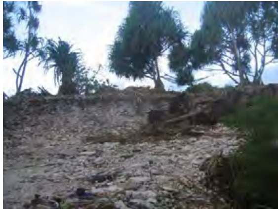
写真 5.46 ストームリッジ背後の掘り崩し
