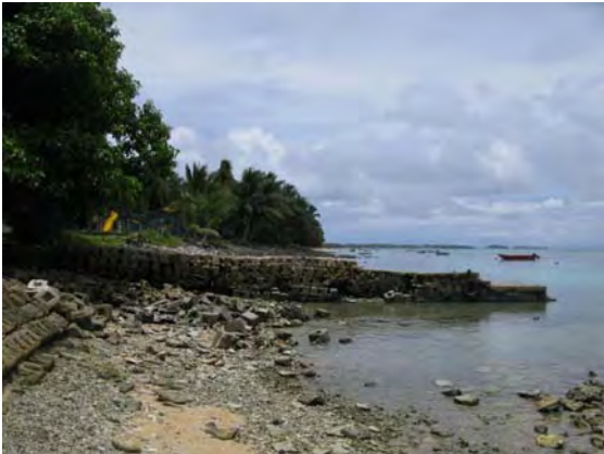
写真 5.22 ブロック塊を流用した突堤
