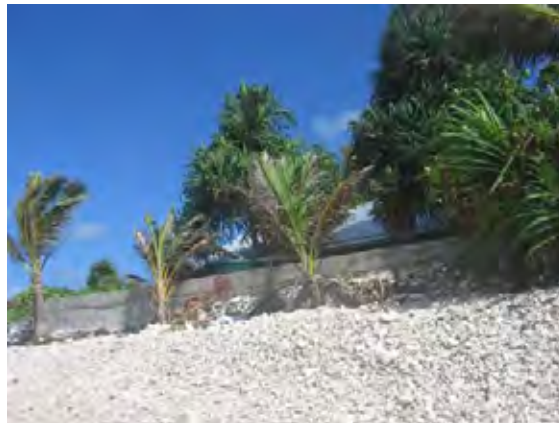
写真 5.40 個人による護岸工の例 コンクリート護岸 Ocean Side No.4
