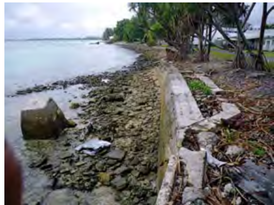
写真 5.25 公共事業による護岸工の例 Vaiaku Wharft 北側の直立護岸 (一部フトン箆式護岸の跡が見られる)
