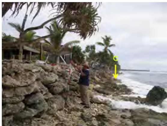
写真 5.36 個人による護岸工の例 Beach rock 片を積み上げた石積み護岸 Ocean Side No.2
