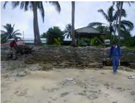
写真 5.28 個人による護岸工の例
