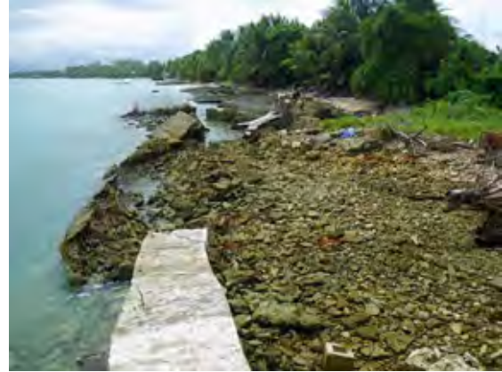
写真 5.31 個人による護岸工の例 不適切な構造で崩壊したもの
