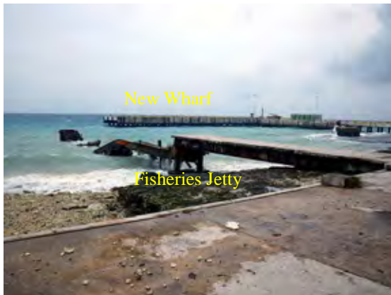
写真 5.2 崩落した水産センター栈橋
