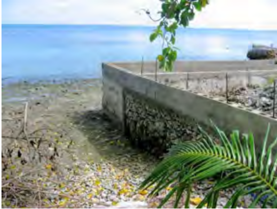
写真 5.30 個人による護岸工の例 下部はじゃ籠、上部は笠木コンクリート
