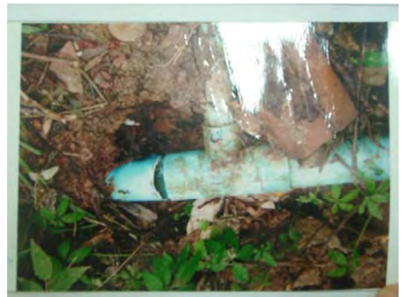
写真-3 バッタバン 更新配水管の計画路線（R11-2 路線） 老朽配水管が、地上に露出し破損している。
