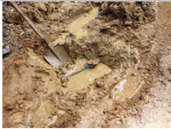
写真-1 プルサット 更新配水管の計画路線（R11 路線） 漏水による給水管（塩ビ管）の補修工事。配水管の材質は普通铸铁で、漏水修理が頻繁に行われている。
