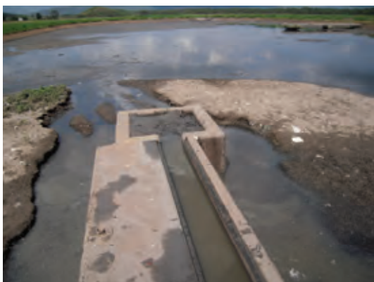
写真 3-2 Njoro 下水処理場の嫌気性池
