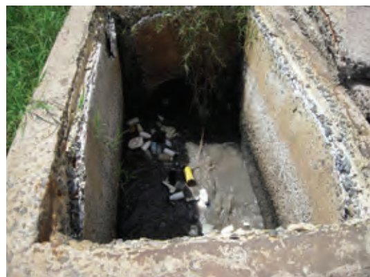
写真 3-3 下水処理場でのコンクリート腐食状況
