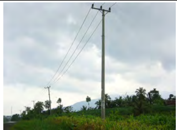
用地沿いに3相-3線、20kV、50Hzの送電線
