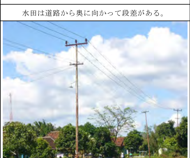
道路沿いの3相 - 3線、20kV、50Hzの送電線
