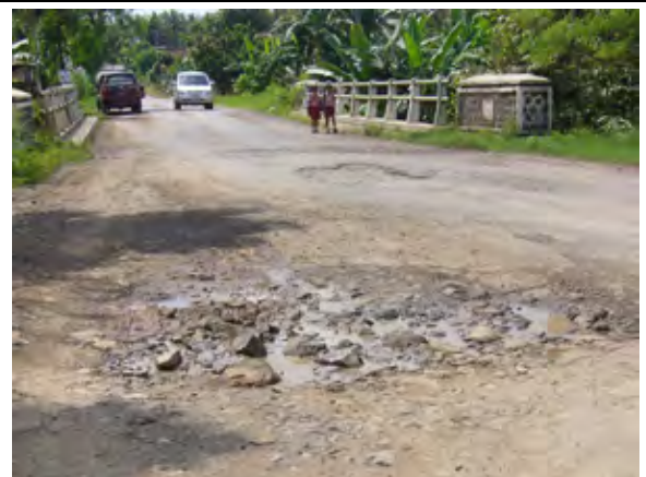
国道からサイト間の橋と損傷した道路状況
