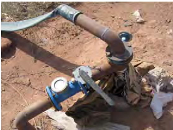
地下管水路排水口と地上排水パイプ(錫尼鎮)
