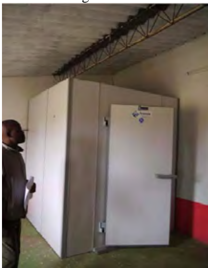
Refrigeradora donada por el proyecto de seguimiento
