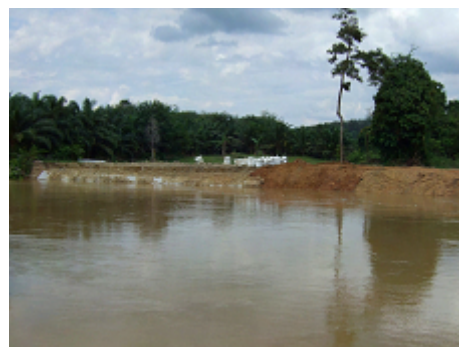
Semantan RiverのMentakab Districtの河岸侵食対策としてソフトロック工法を実施している
