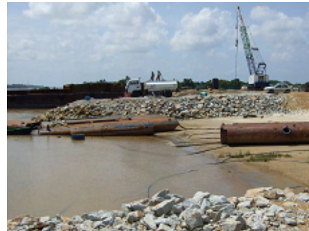
Kuala Pahang の河岸防止工（石積み水制）
