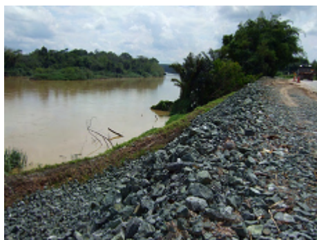
パハン本川沿いの河岸侵食、対策として根固め部分に蛇籠設置、法面保護とリップラップ工を実施
