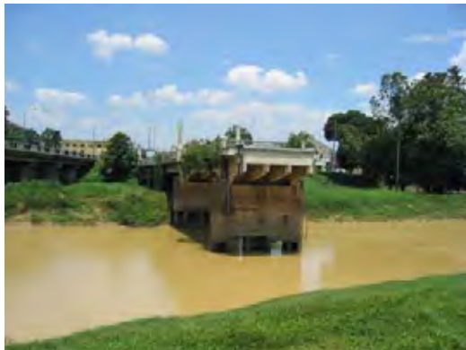
Kg. Kuning Patah 地点のムアール川に残された橋の残骸
