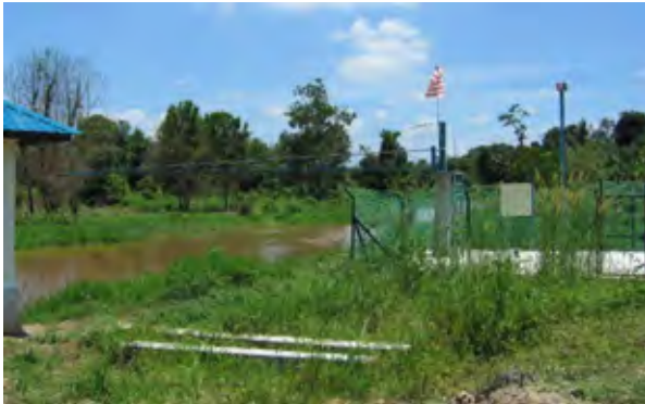
洪水警報サイレン (Pago 村, Muar 川)
