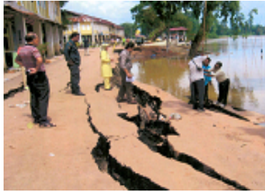
河岸崩壊 (Night Market, Panchor, 2008年4月)
