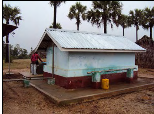
中央乾燥地の給水施設 給水タンク(技術協力プロジェクトで建設)
