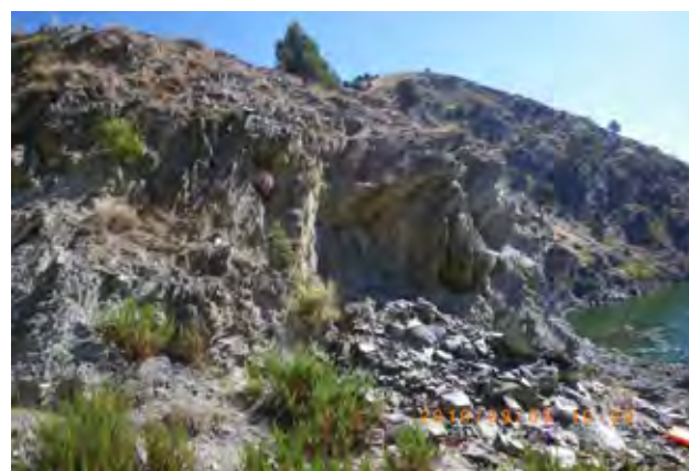
写真 5.29 放水口計画位置に分布する滑り岩塊に見られる表層部の緩み
