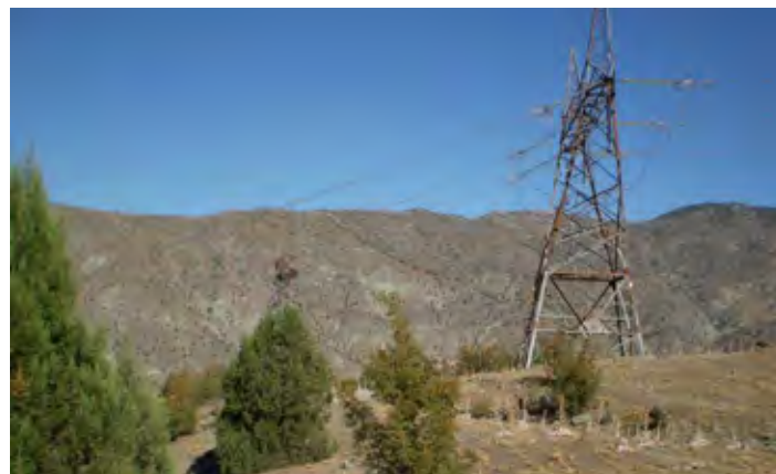
写真 5.49 既設開閉所から上流側へ延びる送電線（2系統）
