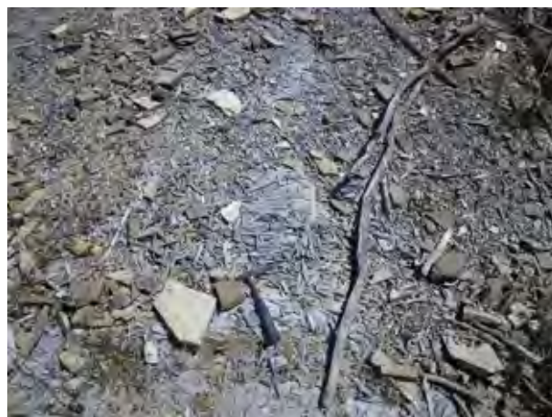
写真 5.10 スレーキングにより棒状に砕けた泥岩
