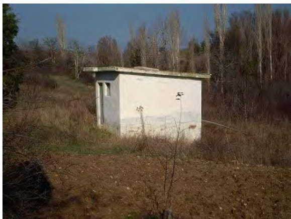
写真 5.35 既設のポンプ設備
