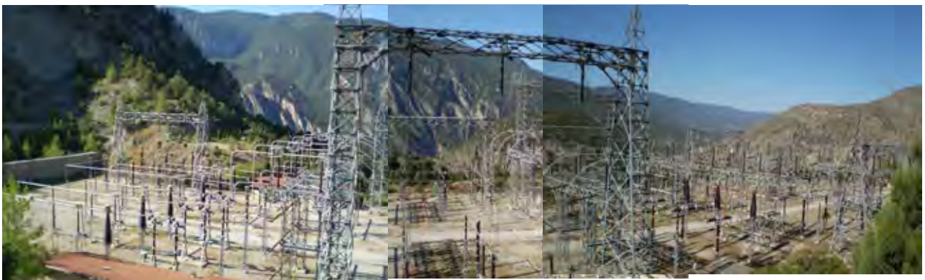
写真 5.48 既設開閉所（ダム左岸上流）
