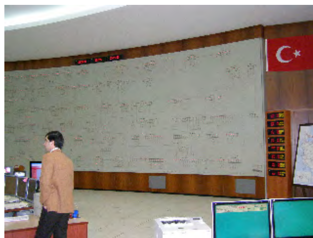
写真 3.2 NLDC 指令室の監視盤
