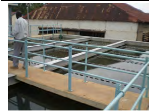
既存の浄水場の沈殿地。設計ないし施工の問題により、浄水が適切に集水できていない箇所があるのが伺えた。
