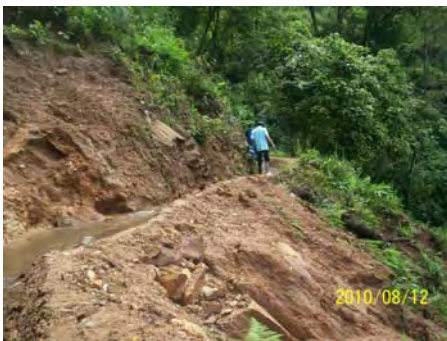
洪水で破壊された水路
