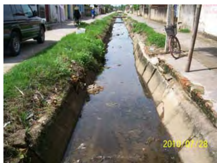
幹線用水路の変状と廃棄物の投棄
