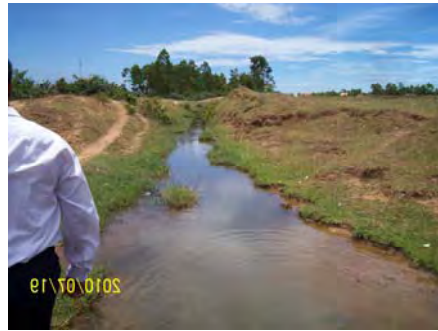
北幹線水路の変状・崩壊
