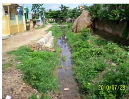
二次用水路の変状と廃棄物の投棄
