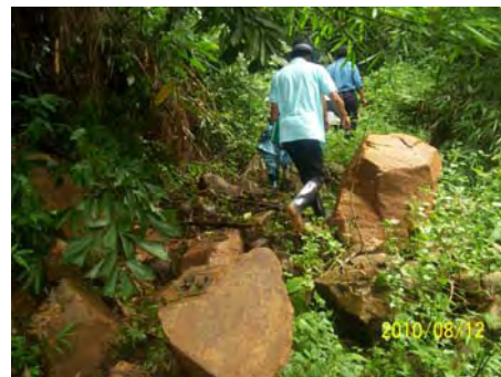
落石で破壊された水路
