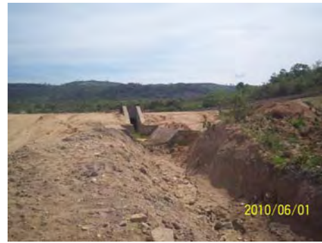
洪水で破壊された水路
