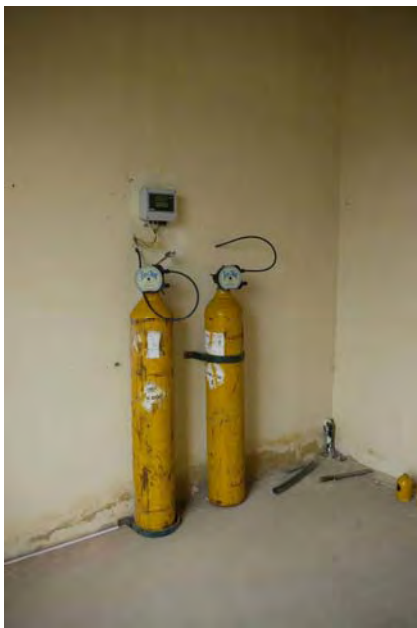
液化塩素貯蔵容器とクロリネーター
