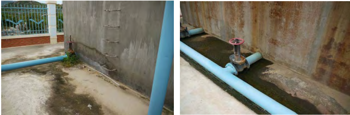
図 8.2-1 鉄筋コンクリート構造物からの漏水
