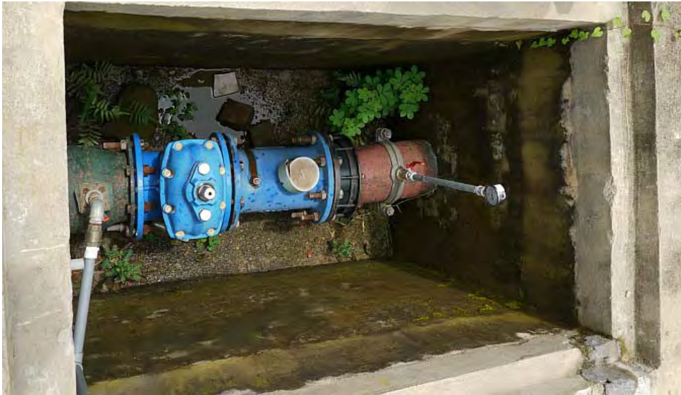
図 5.1-3 流量計設置状況
