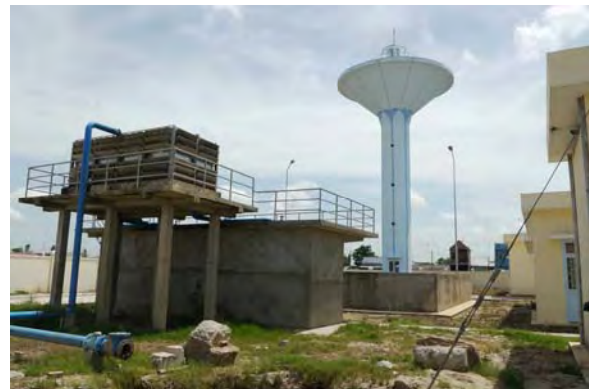
落水タイプ曝気設備
