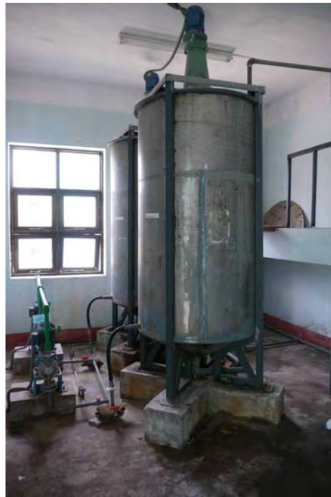
図 4.1-5 薬品注入設備 (薬品溶解槽、攪拌機及び薬液注入ポンプ)
