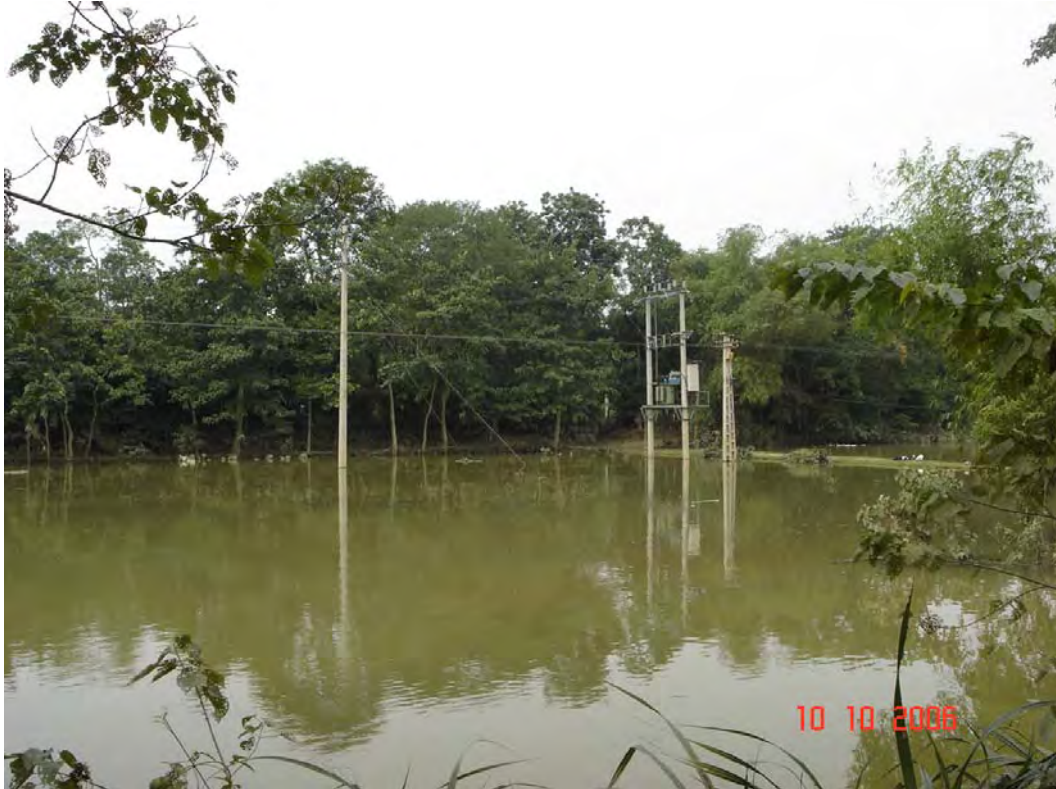
図 4.3-1 Ha Tinh 省 Huong Son 郡 Son Thinh コミューンにおいて冠水した配電施設
