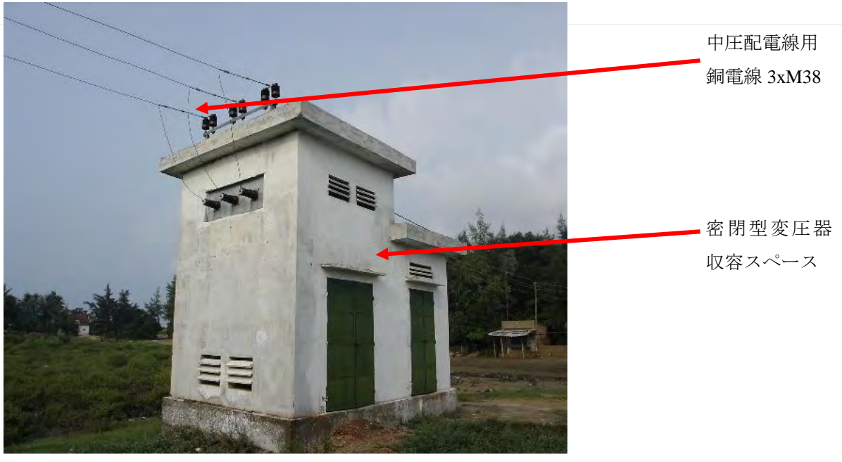
図 4.1-7 Ha Tinh 省 Cam Xuyen 沿岸郡の Cam Nhuong コミューンにおける配電線
