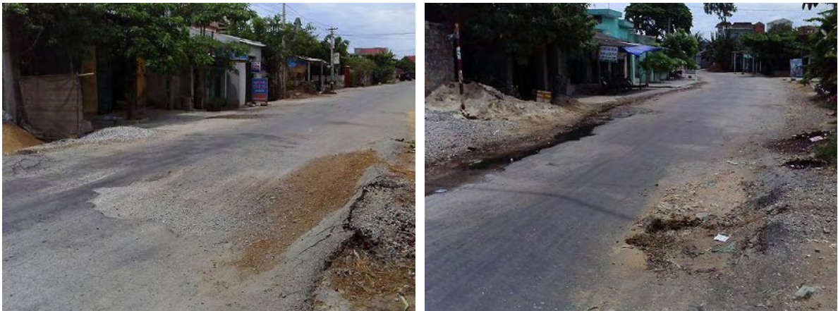
図 4.3-22 Km 1+100 付近の損傷および Km 6+450 付近の損傷
