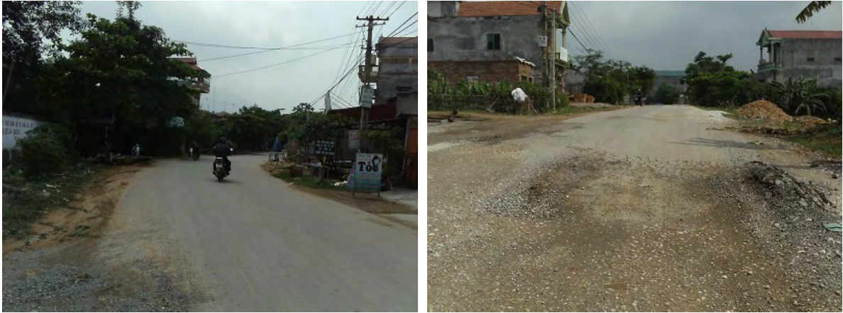
図 4.3-19 Km 1+150 付近の標準的な状況、局所的な轍掘れ
