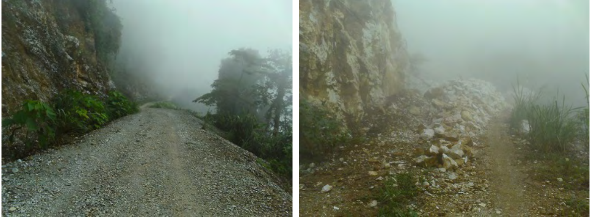
図 4.3-1 Km 5、Km 6 の落石跡
