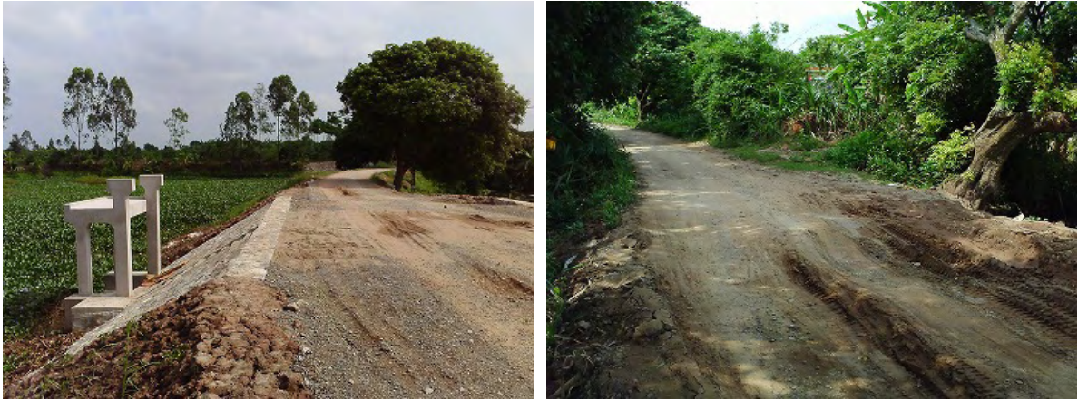
図 4.3-21 Km 4+000 付近の標準的な状況および局所的な轍掘れ
