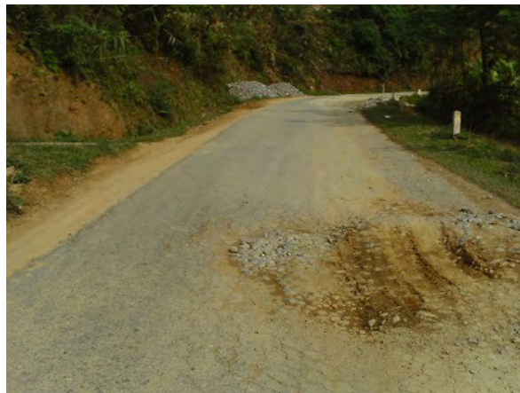
図 4.3-12 Km 6 付近のポットホール
