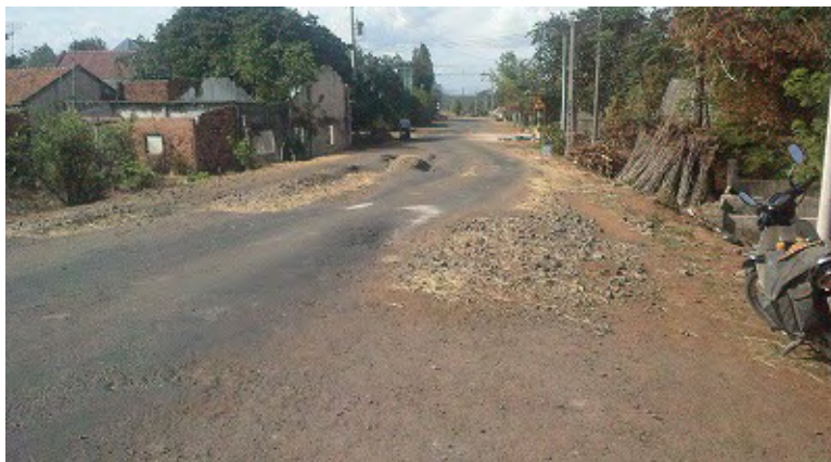
図 4.3-24 Km 7+700 付近の損傷
