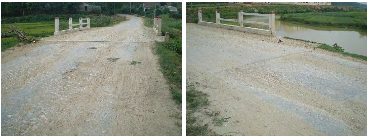
図 4.3-16 Km 1+500 付近の橋梁防護柵ビームの脱落
