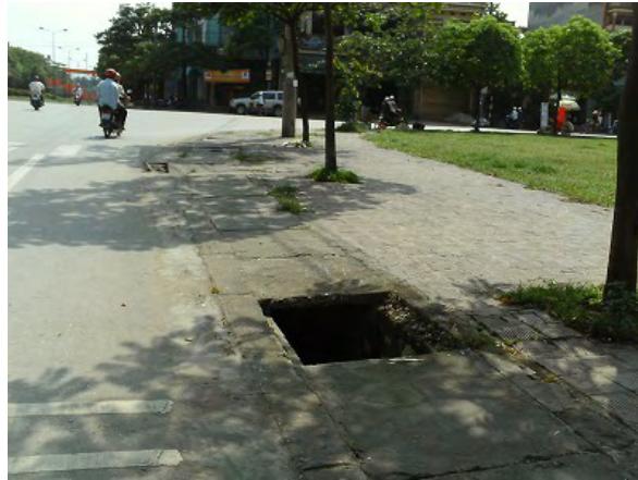
図 4.3-15 排水側溝の蓋がない状況
