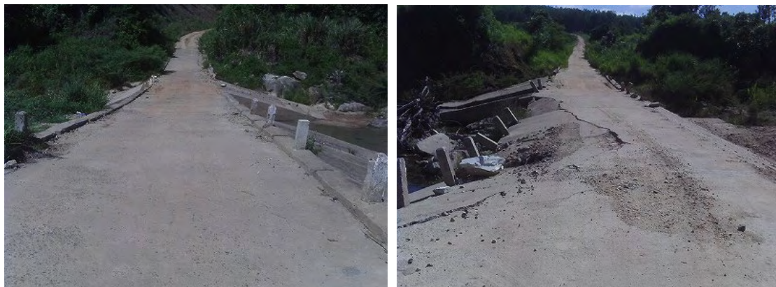
図 4.3-9 Km10+800 付近の標準的な道路状況、Km10+850 付近の損傷したスピルウェイ（潜水カルバート）
