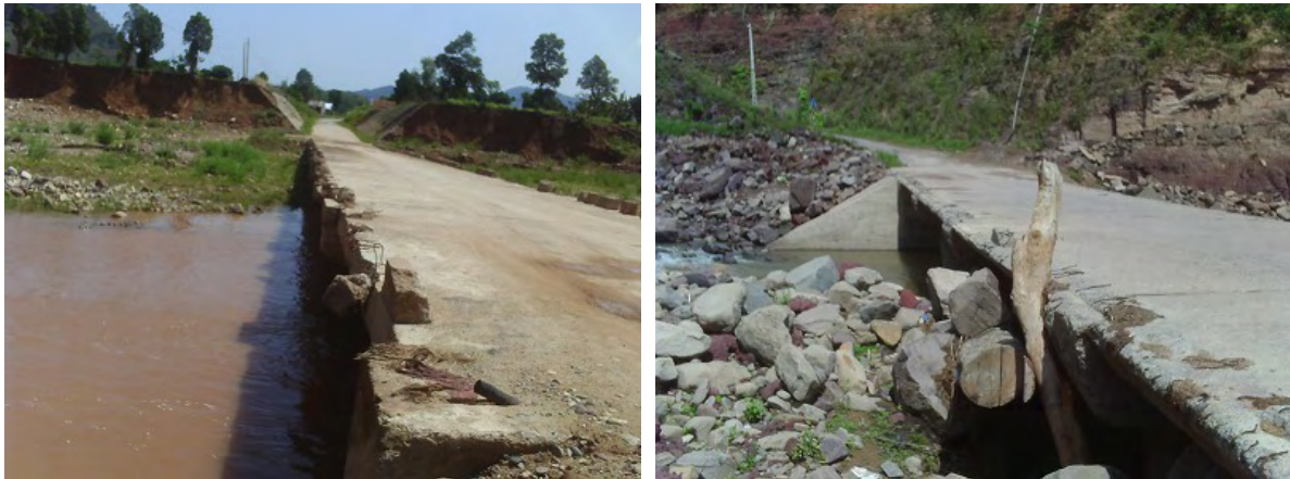
図 4.3-8 地覆部の損傷した、Km 1+200 付近、Km 4+450 付近の橋梁
