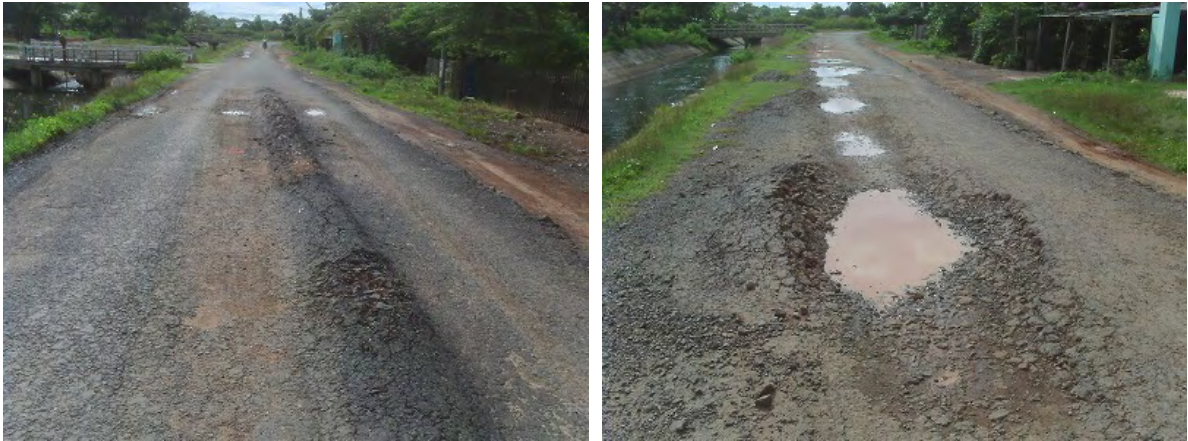
図 4.3-23 Km 0+700 付近の損傷および Km 0+850 付近の損傷
