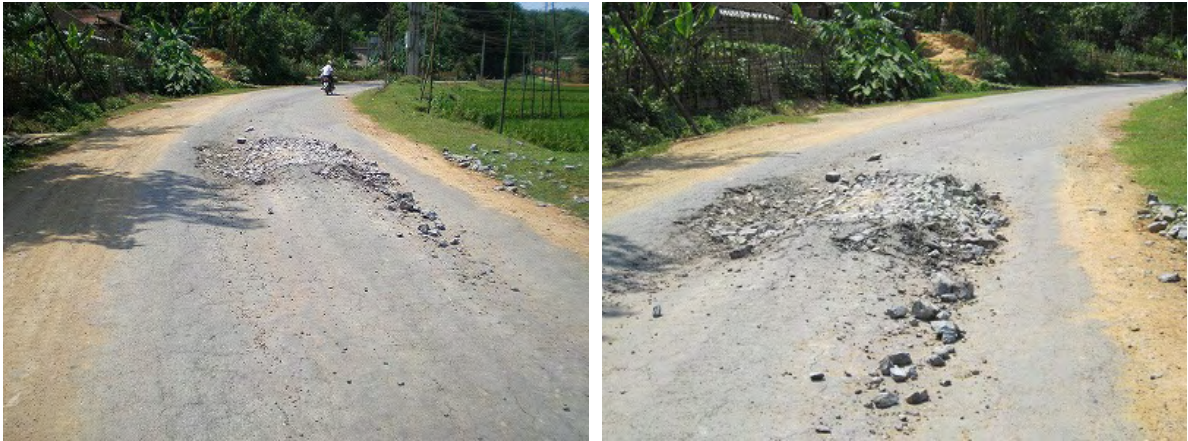
図 4.3-17 Km 8～Km 9 付近の局所的なポットホール
