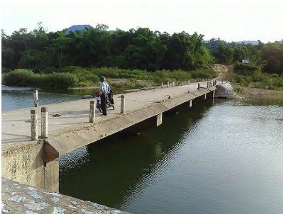
図 4.3-6 転落防止ポストの脱落状況
