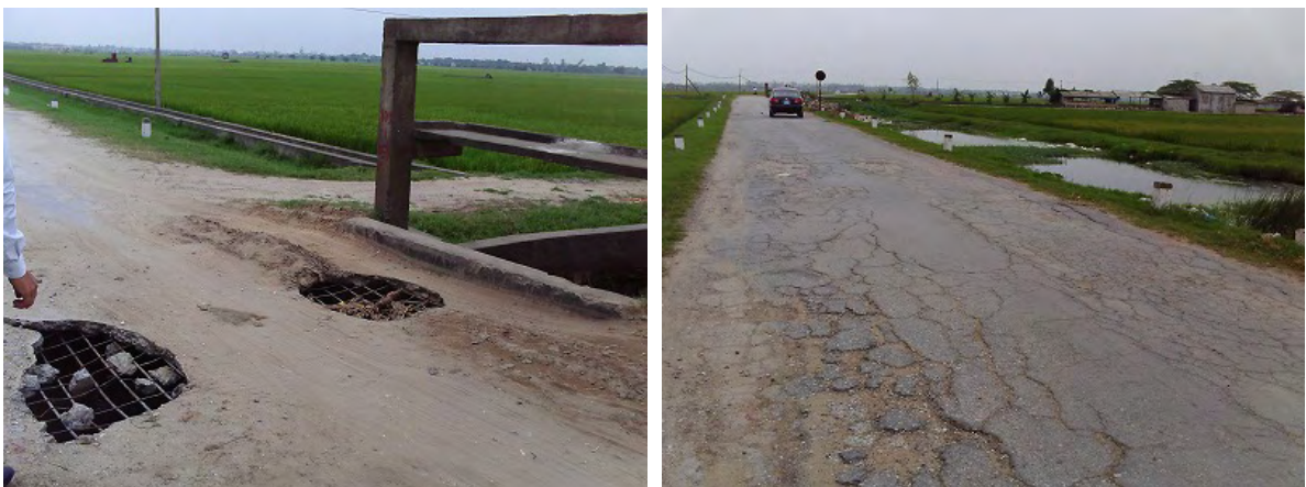
図 4.3-20 Km 5+000 付近の Quan Thu Bridg の床板抜け落ちおよび橋台背面の路面状況
