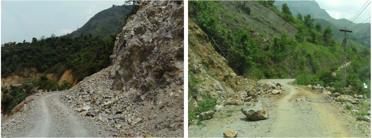
図 4.3-5 崩壊性岩盤壁を有する道路
