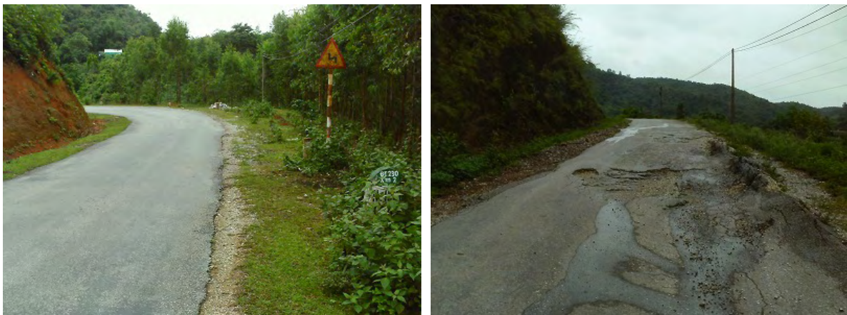
図 4.3-14 Km2+800 付近の標準的な状況、および局部的轍掘れ
