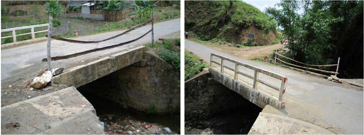
図 4.3-11 Km 12+700 付近 橋梁防護柵の脱落
