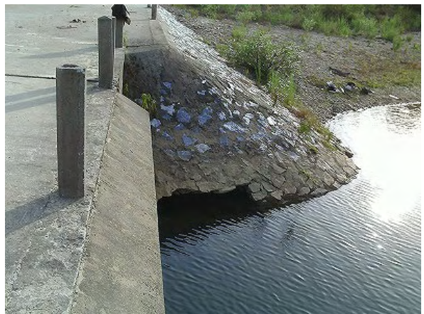
図 4.3-7 護岸工の損傷
