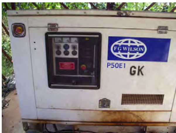
KEMSA所有発電機: 本計画施設の電源を受ける。
