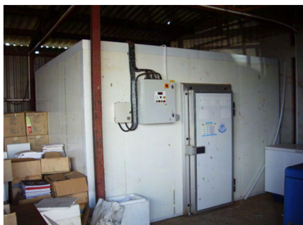
KEMSA倉庫内部: 計画敷地の脇に位置し、DVI用コールドルームが設置されている。
