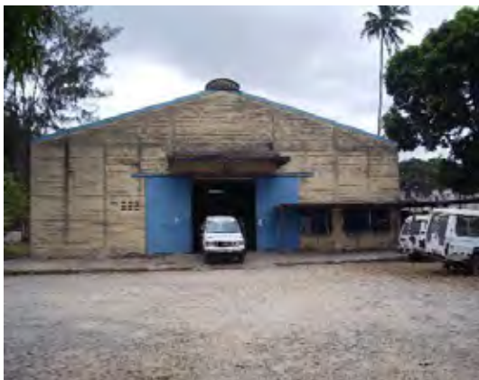
KEMSA倉庫外観:KEMSA倉庫入り口にローディングベイは設置されていない。
