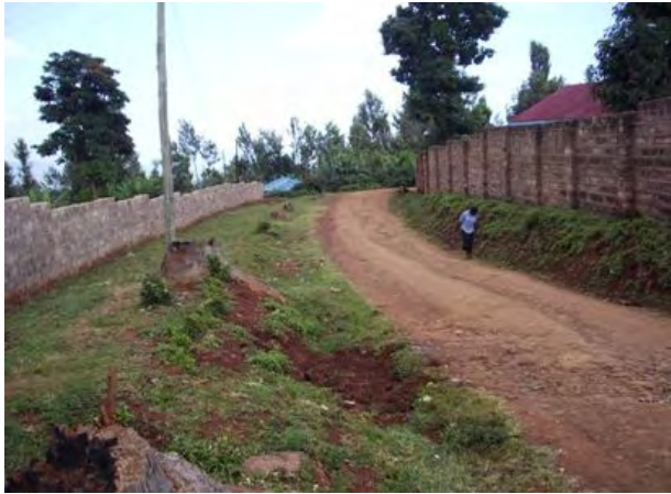
前面取付け道路：舗装されていない急勾配の取付け道路。
