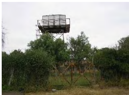
ヘルスセンター敷地内高架水槽:本計画施設もこの高架水槽から上水の供給を受ける。
