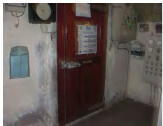
コールドルーム:老朽化しておりワクチンの保管は不能である。
