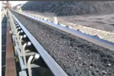
受入系統ベルトコンベヤ 能力 1,550 t/h, 全長約 1.3km
