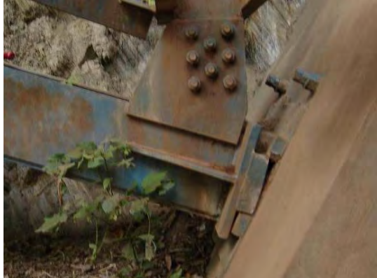
写真-4：アーチ支承部の不具合。アーチ支承全4か所が同じ状況を成し、支承上側が橋台コンクリートから浮いている。
