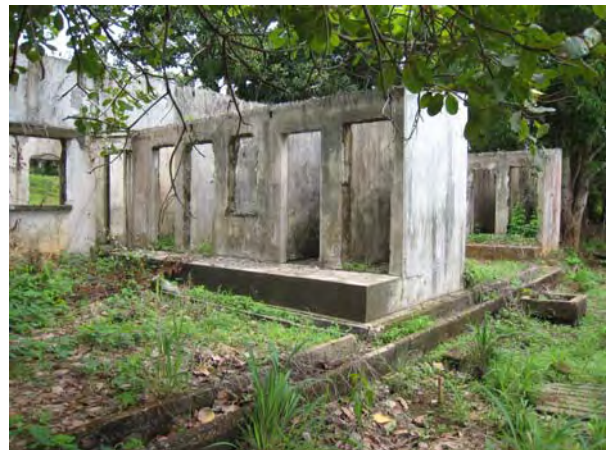
写真6：既存浄水場内の建屋 運転要員の宿舎。内戦中に破壊されて使用不能。基礎部分を残して修復を行う。
