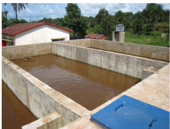
写真 15：ロクプール浄水場の緩速ろ過池 先行して実施された技術協力プロジェクトで建設された緩速ろ過池。
