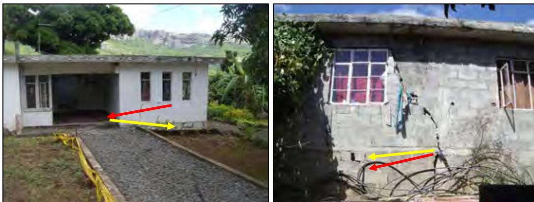
図 3-4-7 被災家屋の傾斜方向（黄矢印は斜面の傾斜方向、赤矢印は家屋の傾斜方向）
