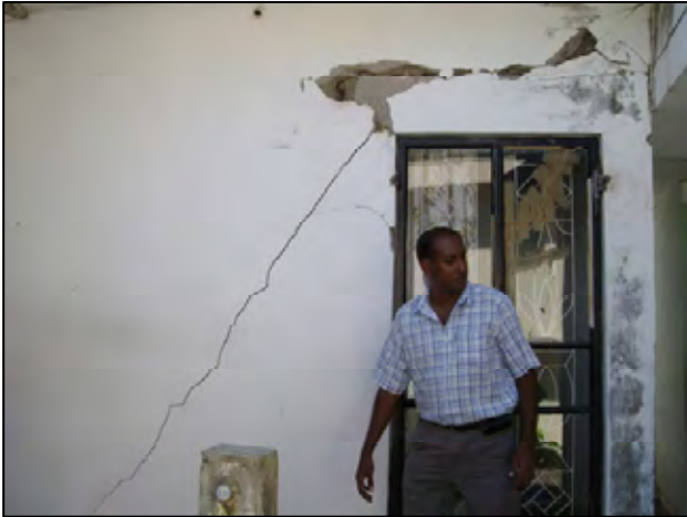
Citrakoot 地区の地すべりにより被害を受けた家屋① この家屋の内壁には大きな亀裂が生じている。現在、この家屋に居住者はいない状況である。
