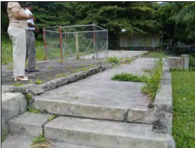
Citrakoot 地区にある小学校の校舎跡 地すべり被害により被災して校舎は撤去された。残された基礎部分に段差や傾きなど地すべりによる被害がある。
