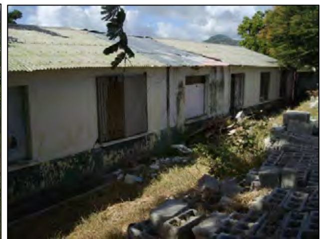
ラ・ビュッテ地区にある小学校 地すべりの影響で、外壁に亀裂が生じている。被災後、学校は他の場所に移転し、使用されていない。
