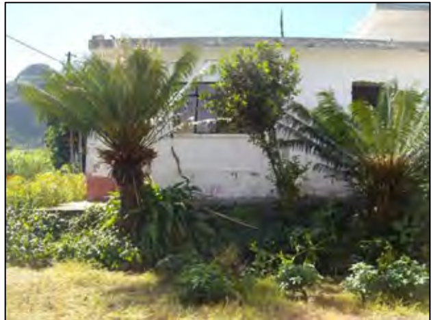
Citrakoot 地区の地すべりにより被害を受けた家屋② 「Citrakoot 地区の地すべりにより被害を受けた家屋①（左写真）」の外観で、外壁にも大きな亀裂が生じている。
