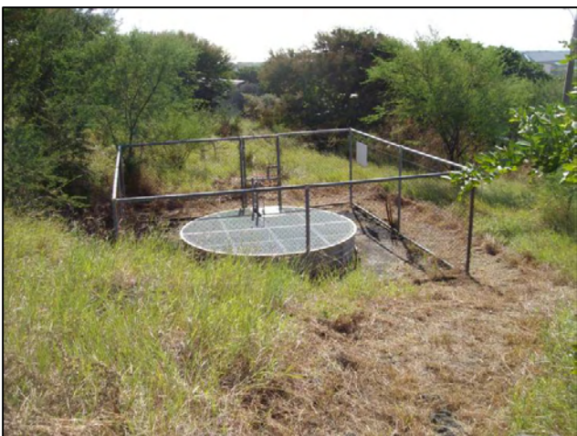
ラ・ビュッテ地区の地すべり地にある集水井 ごく一般的な集水井で、外観も機能も問題はないと思われる。
