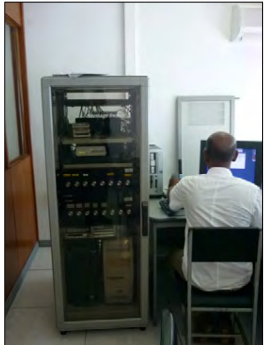
GTS (Bacoas) 国際回線でサイクロン・観測情報を送信する装置。気象衛星データ・数値予報データ受信装置も一緒に格納している。
