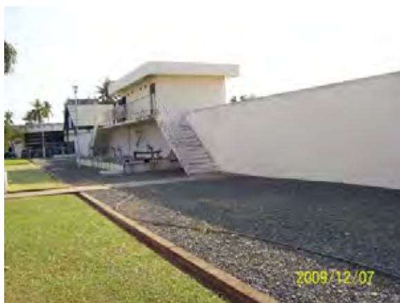
第2配水池建物 今回 PV システムを設置する第2配水池建物。1996年に JICA の無償資金協力で完成。
