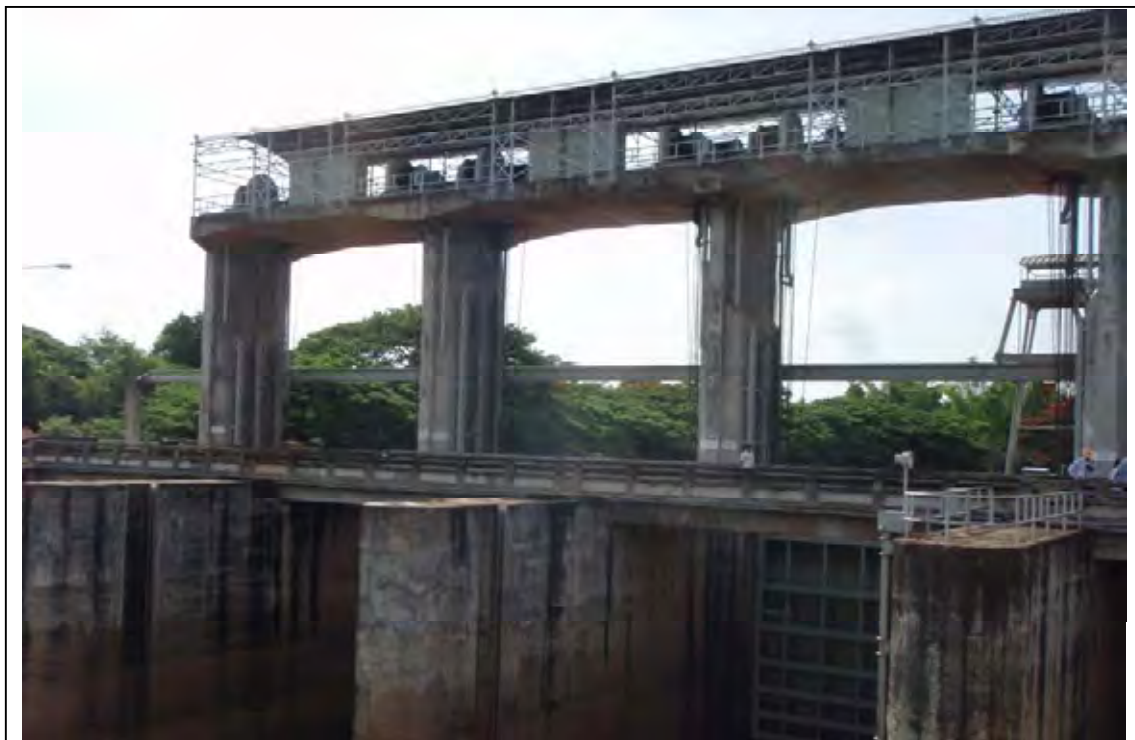
ウドンタニ県に位置する Huai Luang 河口堰：メコン川の支流の Huai Luang の河口に建設された河口堰である。雨期には、メコン川からの逆流を阻止し、乾期には Huai Luang の流出を貯留するための堰である。Huai Luang の流域面積は 4,340km 2 、全長 100km に及ぶ。
