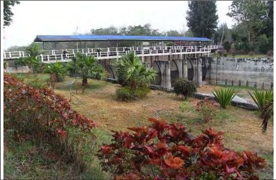
ナコンラチャシマ県に位置する Lam Takhong ダムの余水吐ゲート。ラディアルゲートが設置されている。
