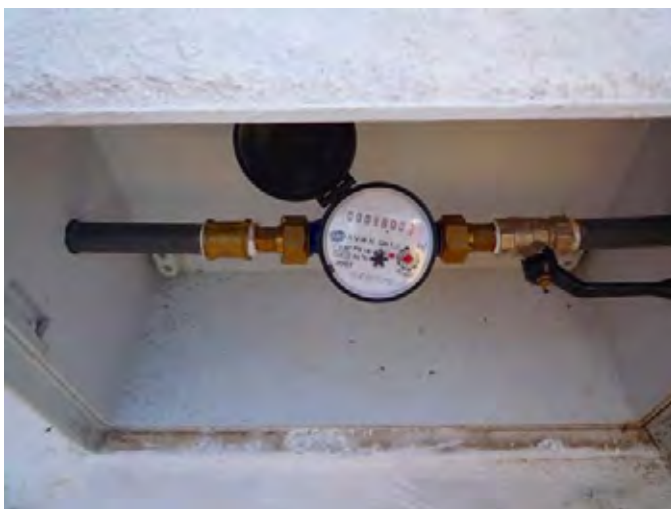
Toque metros medição de água
