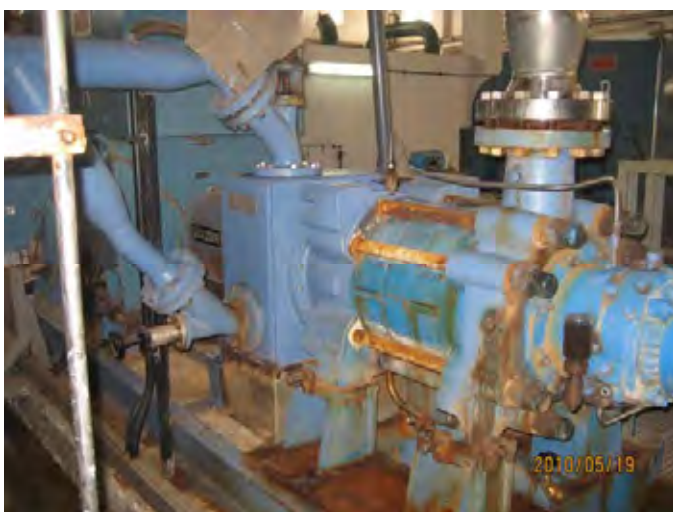
エネルギー回収装置付高圧ポンプ (プライア市パルマレージョ)
