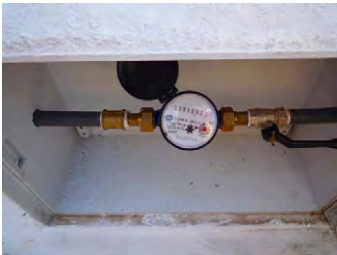
家庭用水道メーター
