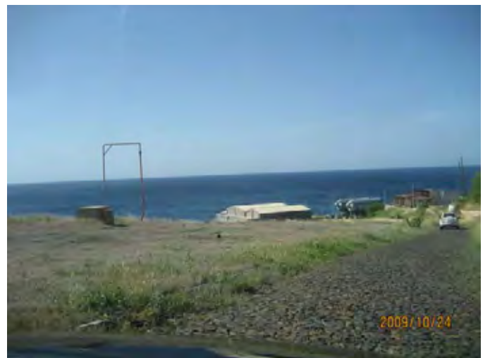
プライア市近郊にある海水淡水化設備全景（ELECTRA 社が操業）
