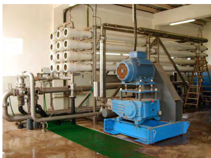
エネルギー回収装置付高圧ポンプ (サル島)
