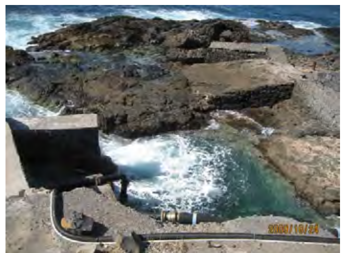
蒸発式（MED）海水淡水化設備に使用されていた取水設備
