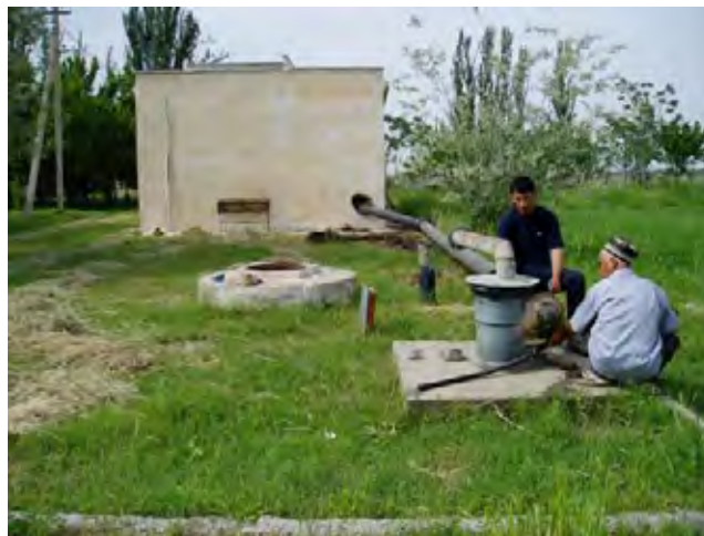
写真-8 【メハナタバッド・ジャモアット、メハナタバッド村】 1961年建設され老朽化が進んでいる井戸。ここからメハナタバッド村近隣の計6村(人口19000人)に給水を行なっているが、遠隔の村落への給水は送水管の破損や水圧不足のため困難な状況である。
