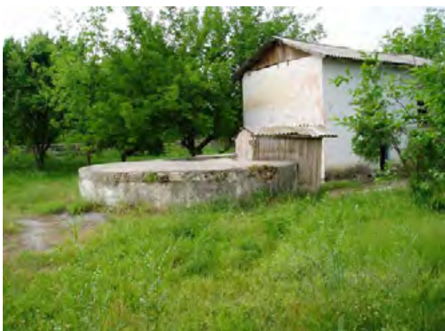
写真-1 【モスクワ町ボドカナル深井戸】 No.2深井戸の地上部外観。右建物は操作盤室と塩素注入器室。
