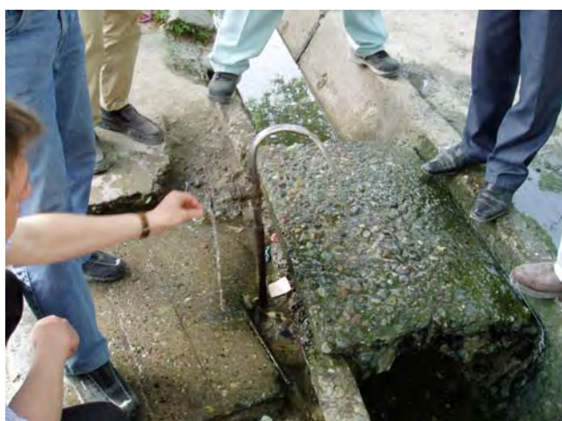
写真-6 【モスクワ町共同水栓】 道路脇に設置された共同水栓。全市に32箇所ある。
