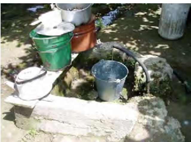
写真-5 【モスクワ町の各戸給水栓】 民家の敷地内の各戸給水栓。蛇口が無かったり、壊れているものが多く、垂れ流し状態である。給水時間は朝夕2回で計12時間/日である。
