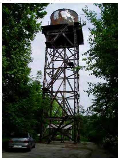
写真-4 【モスクワ町ボドカナル高架水槽】 鋼製タンク容量100m 3 。高さ20m。老朽化による漏水のため使用されていない。そのため、井戸ポンプから配水管網に直接送水されている。
