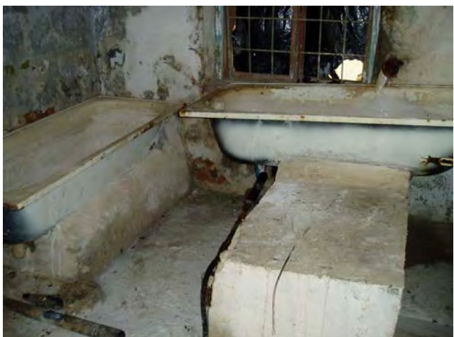
写真-3 【モスクワ町ボドカナル塩素注入器】 さらし粉をバスタブで溶解し、井戸に注入し滅菌を行なっている。そのため、井戸の鋼製ケーシング内面の腐食が顕著である。
