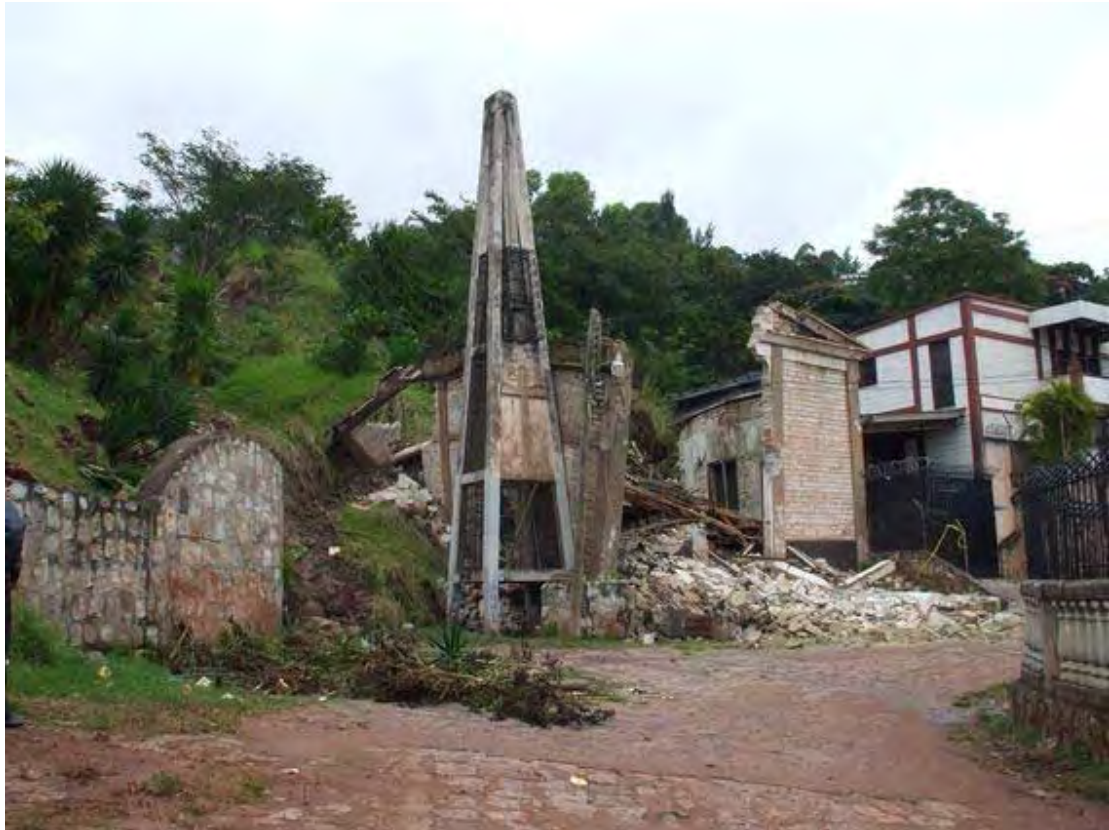
Dstrucción de la iglesia por el empujón del bloque de tierra en el extremo inferior del deslizamiento (28 de octubre 2008)
