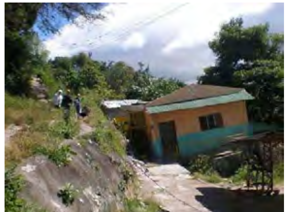
Deformación de la parte superior por depresión
