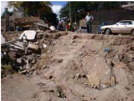
中央部西側の変状
