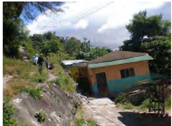
上部のスランプ変状
