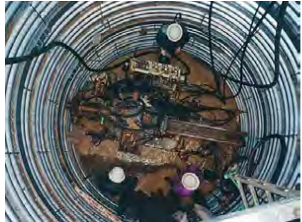
【写真-8】事例写真：施工中の集水井内部。 底部に見えるのは集水ボーリングマシン。
