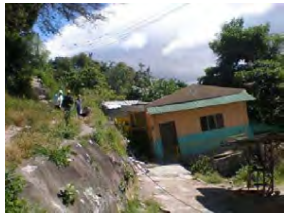
上部のスランプ変状
