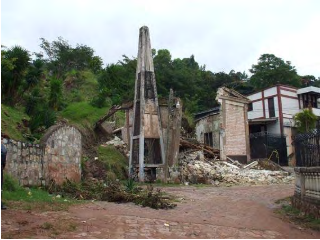
末端部、土塊の押し出しによる協会の破壊(10月28日)
