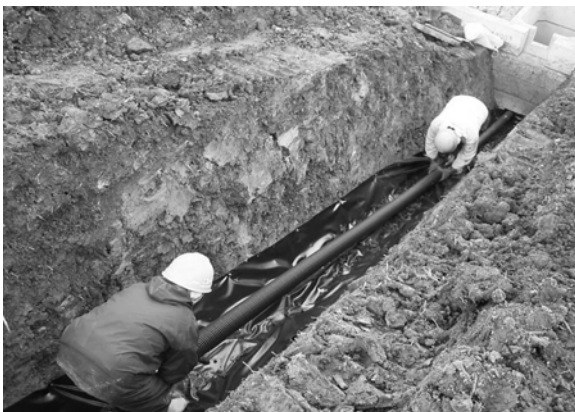
【写真-11】事例写真：明暗渠工(2 階建て水路)の暗渠部分(1 階部分)の排水管の設置工事状況
