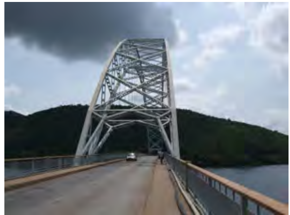
【アドミ橋】橋の主部材はアーチ構造であるが、剛性が小さい主部材を強化することは難度が高い補強作業と考えられる
