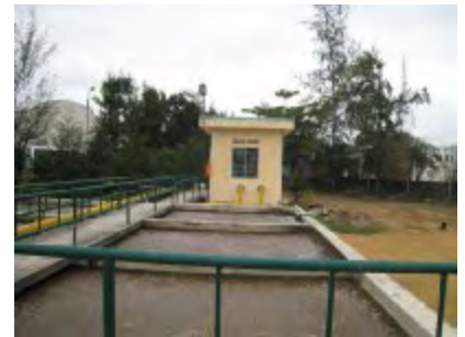
Hệ thống xử lý nước thải tại KCN Đà Nẵng
