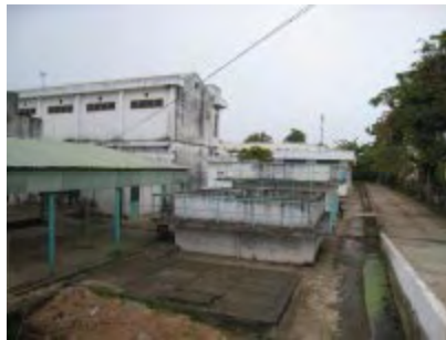
Hệ thống xử lý nước thải tại bệnh viện Cẩm Lệ
