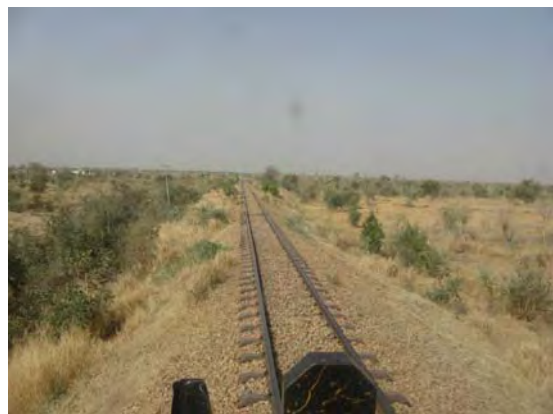
● バラストの流出で危険となった軌道
