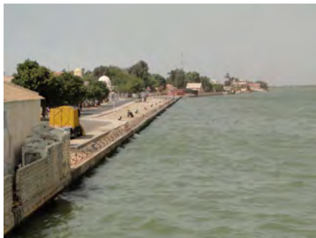
写真1 旧サンルイ港岸壁 (近年に整備された後、使用されなくなったものと推測できる)
