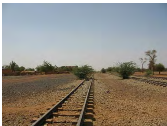
● 同駅構内の線路：バラスト流出
