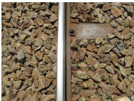
カーブの外軌側で摩耗限度を超えた レール
