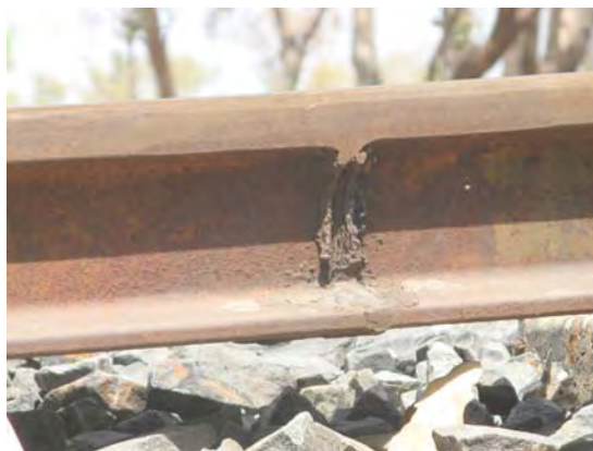
レールの溶接箇所：典型的な欠陥溶接
