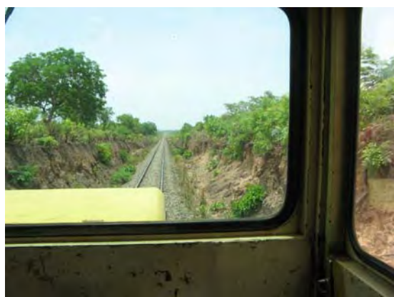
● 右側の法面損傷
