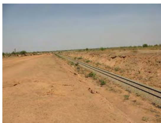
Zitenga 駅～Ouagadougou 駅間 の切取区間：法面の損傷
