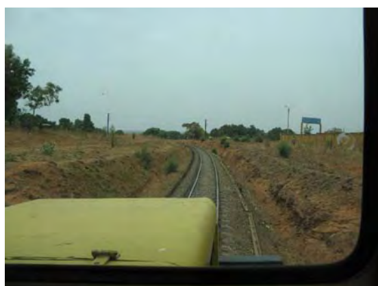
● 右側の法面損傷
