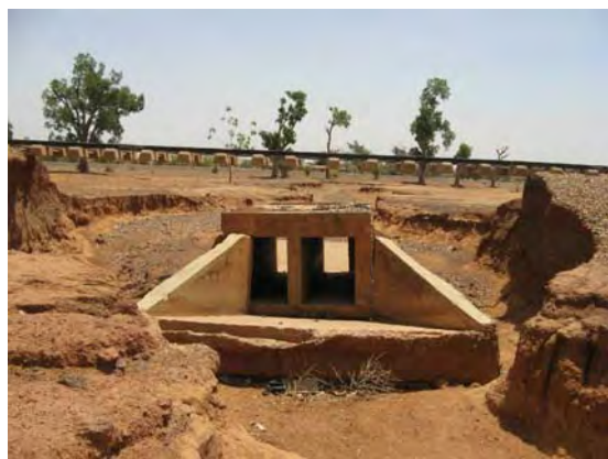
● Kaya 駅～Zitenga 駅間の横断排水溝の被害
