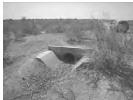
Cross load conduit
