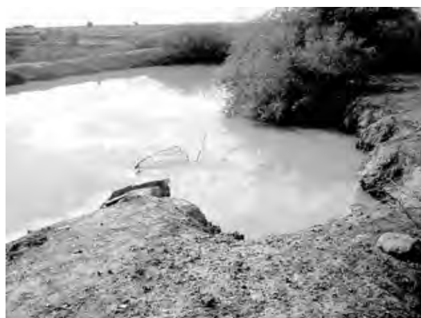
Canal primaire endommagé (P2)
