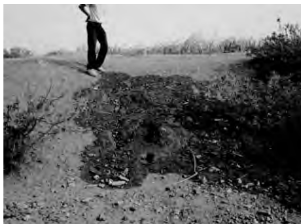
Partie de la digue inondée à 200m en amont de SF7, avant rehaussement
