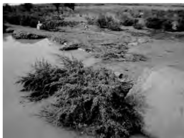
Canal primaire endommagé (P1)
