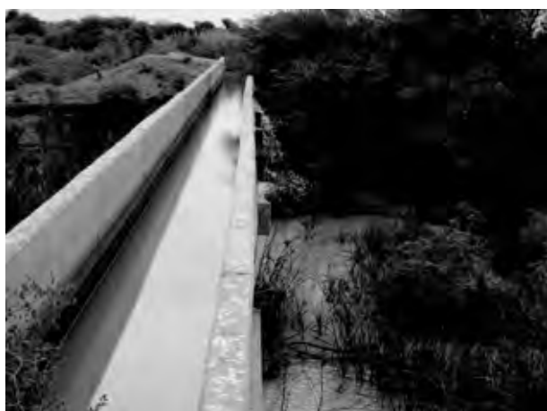
Pont aqueduc endommagé
