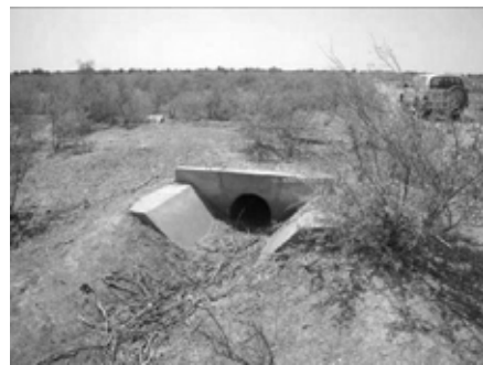
Cross load conduit
