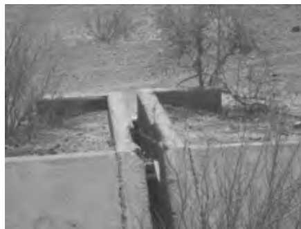
三次水路分水工(Module Amasuk)
