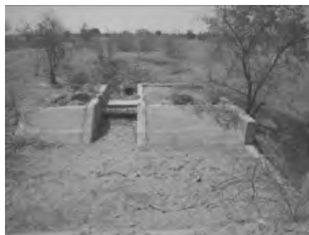
三次水路分水工(Module Amasuk)
