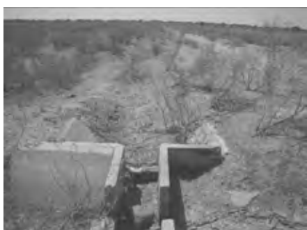
三次水路への分水工
