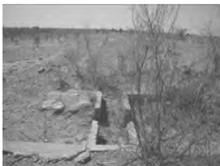
三次水路分水ボックス
