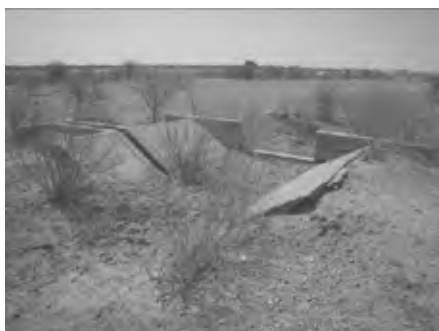
分水位調整堰
