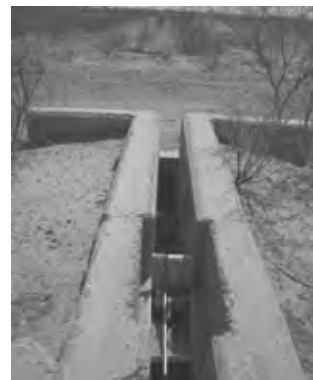
三次水路分水工(Module Amasuk)
