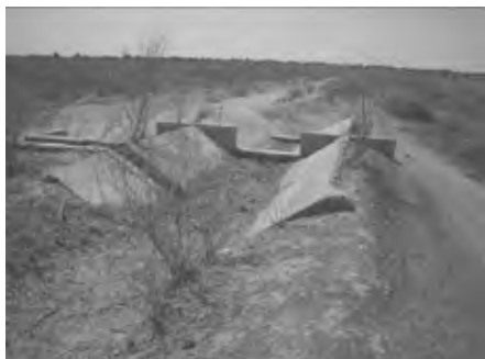
落差工兼分水位調整堰
