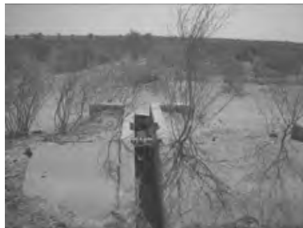
三次水路分水工(Module Amasuk)
