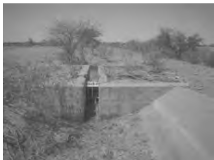
三次水路分水工(Module Amasuk)
