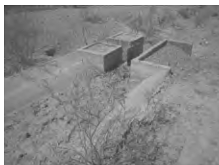
二次水路末端分水工
