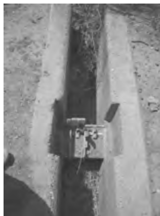
三次水路分水工(Module Amasuk)
