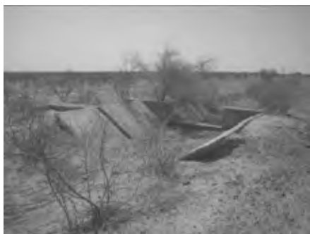
落差工兼分水位調整堰
