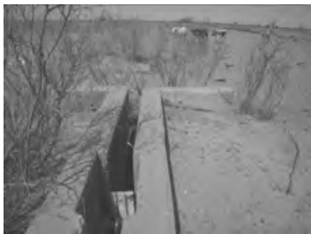
三次水路分水工(Module Amasuk)
