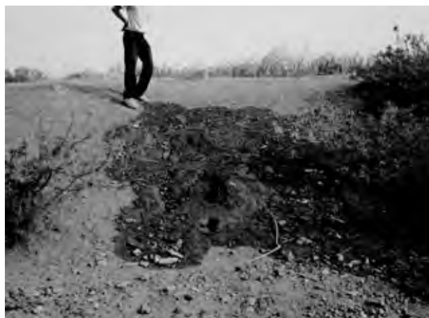
土のう積み前、SF7下流200m堤防浸潤部
