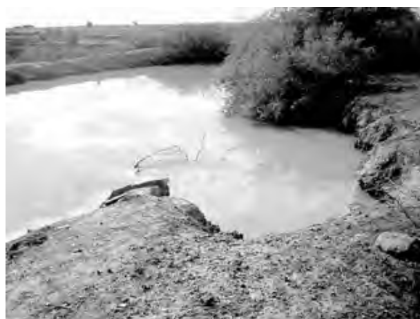
損傷した1次水路 (P2)
