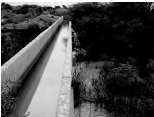
損傷した水道橋
