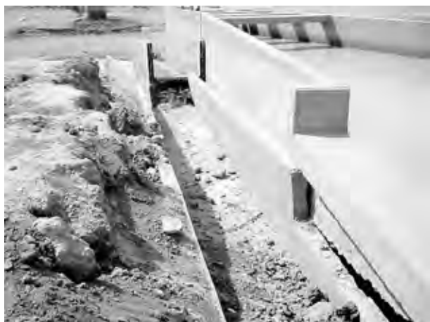
損傷したサイフォン7
