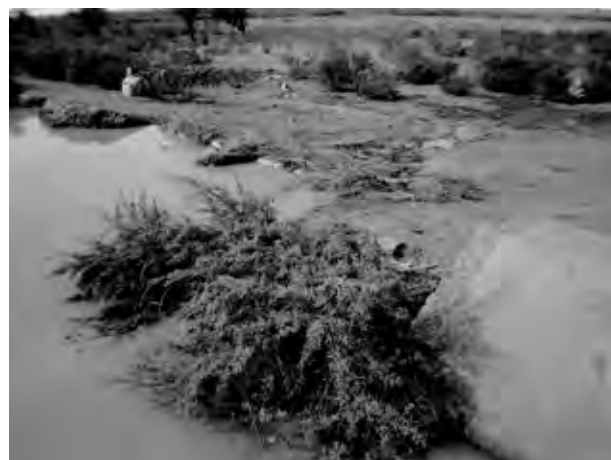
損傷した1次水路 (P1)
